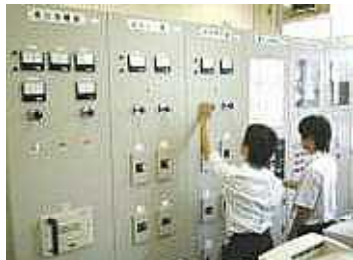
高圧受電盤実習
